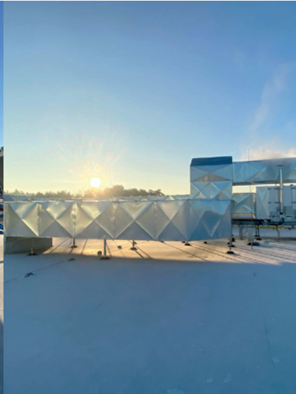
Instalacja wentylacji mechanicznej
