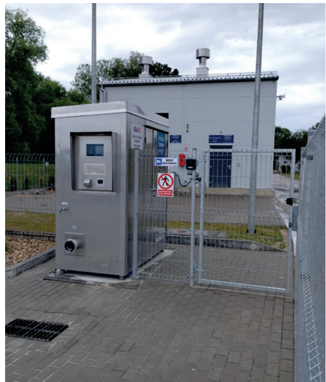
Fot. 2. Stacja zlewna ścieków dowożonych
