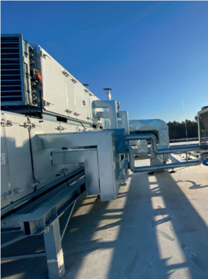
Centrala wentylacyjna z agregatem wody lodowej
